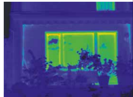
Après le montage soigneux de nouvelles fenêtres Corona CT 70, la thermographie démontre l'avantage énergétique élevé de l'investissement. La perte d'énergie initiale est ainsi presque totalement évitée.
